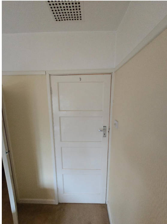
Bedroom door not square
